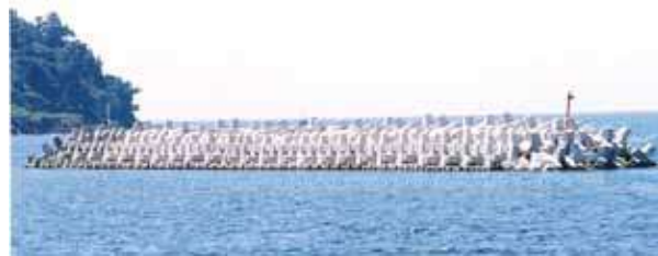
◇ 事例-3：離岸堤 多層乱積：G-50t (富山県入善町 入善漁港海岸)
